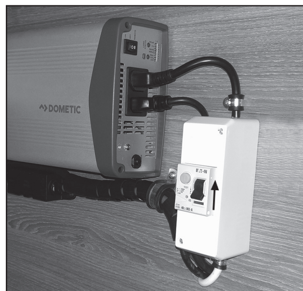
En jordfelsbrytare är monterad vid Invertern.
