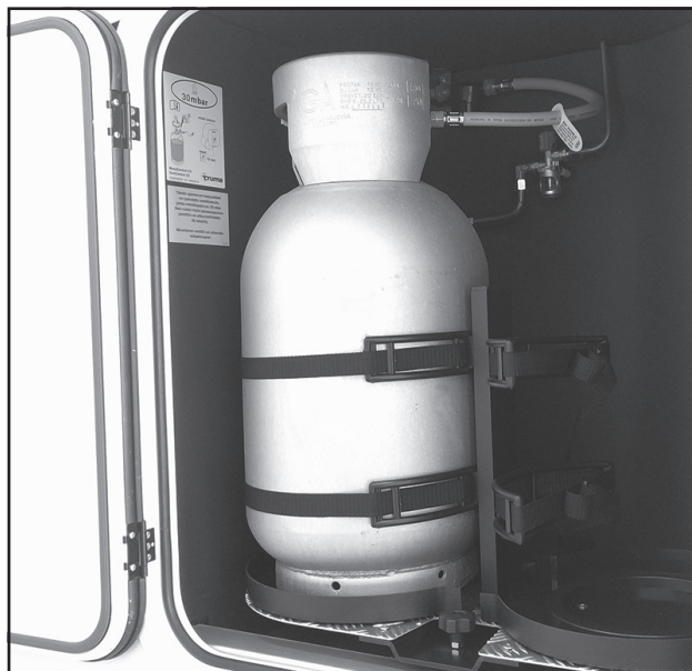
Gassflasken i gasskassen.
