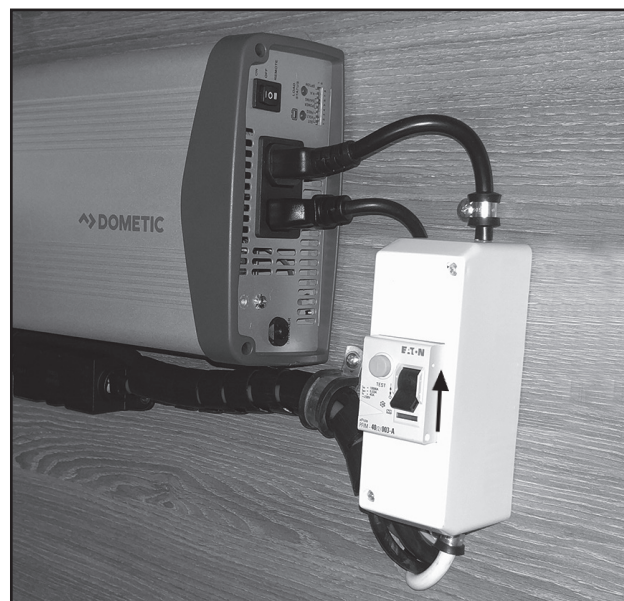
En jordfeilbryter er montert ved inverteren.
