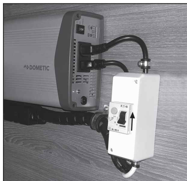
Invertteriin on asennettu vikavirtakatkaisin.
