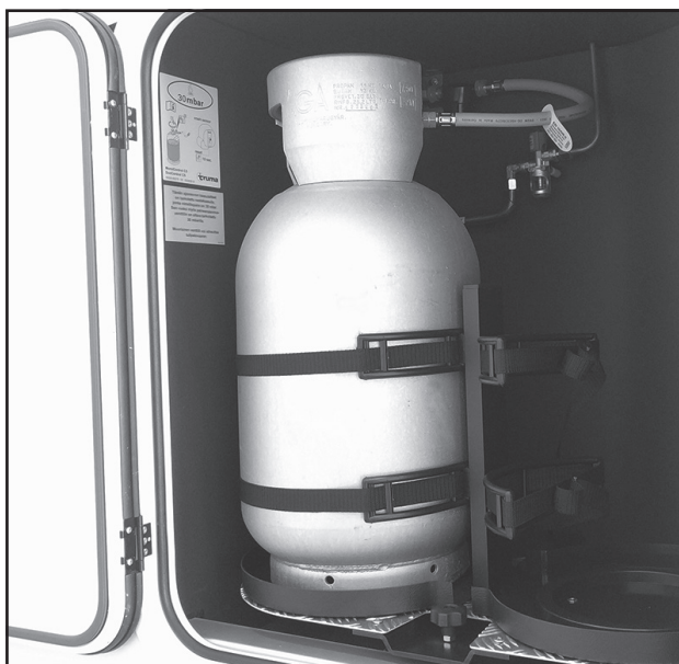
Gassflasken i gasskassen.
