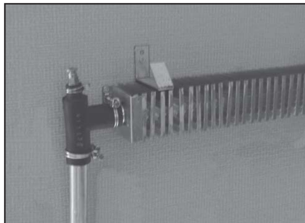
Konvektor och slanganslutning med luftningsnippel.
