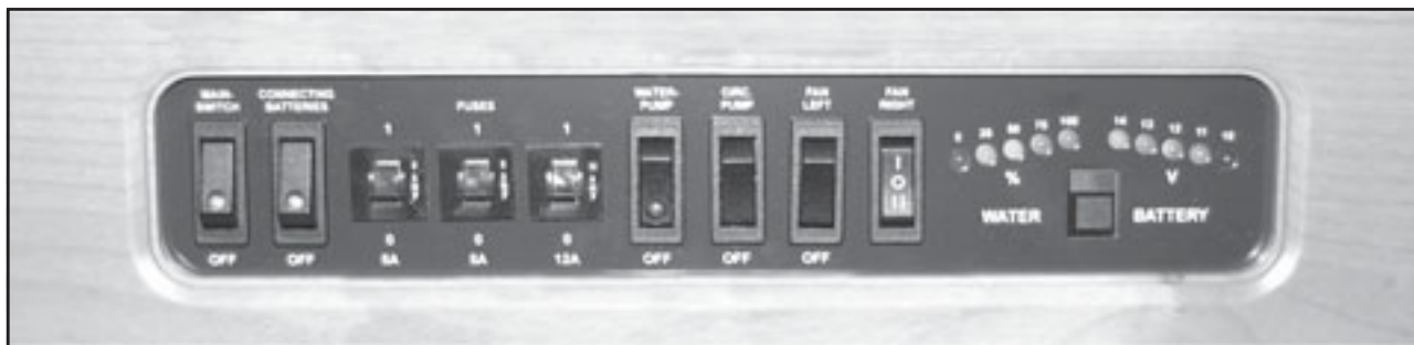
Manöverpanel, stora panelen.
