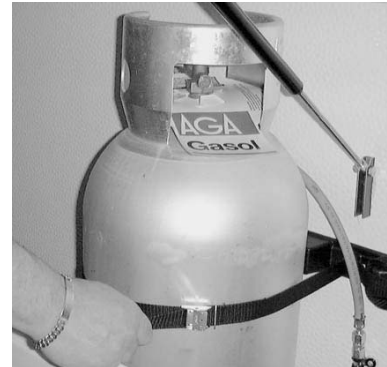
Kontroller at gassflasken er ordentlig festet.
