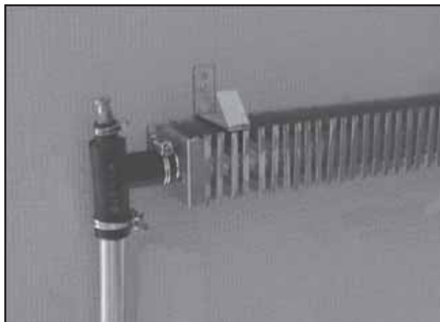
Lämpöpatteri ja letkuliitos ilmausruuveineen.
