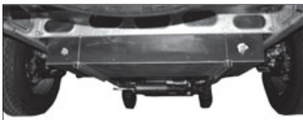
Harmaavesisäiliö on matkailuauton takapyörien välissä.
