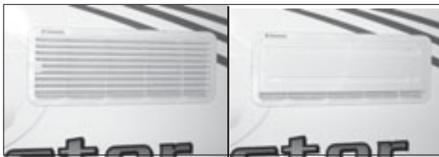
Jääkaapin tuuletussäleikkö kesäkäytössä ja talvisuojan ollessa asennettuna säleikön päälle.
