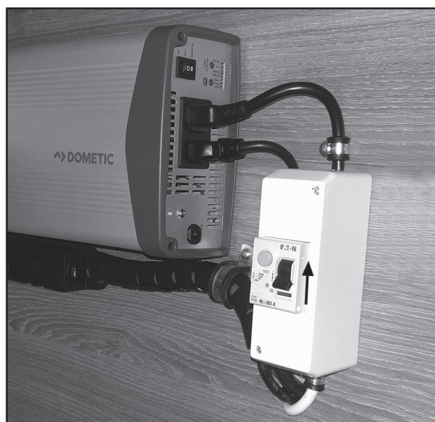
Bij de inverter is een aardlekschakelaar gemonteerd.
