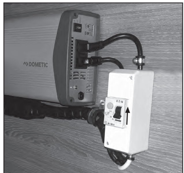
Bij de inverter is een aardlekschakelaar gemonteerd.
