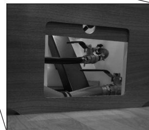
Ventiler for ferskvannstanken: overfyllingsbeskyttelse 20 liter henholdsvis avtapping ved tømming av ferskvannstanken.
