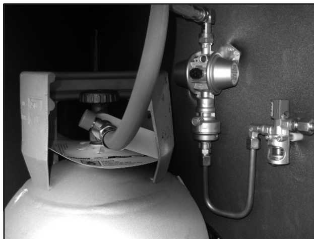
Gassflasken i gasskassen.
