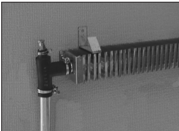
Lämpöpatteri ja letkuliitos ilmausruuveineen.
