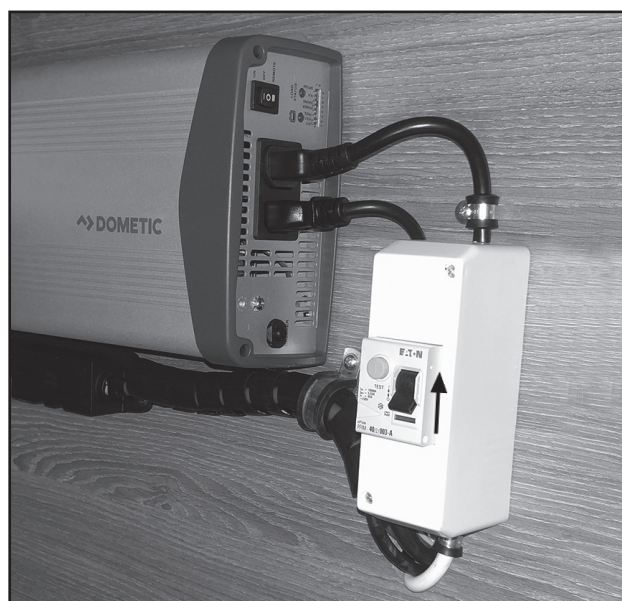
Invertteriin on asennettu vikavirtakatkaisin.
