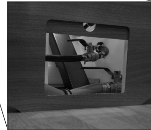
Ventile für den Frischwassertank: Überfüllschutz 20 Liter bzw. Ablassventil beim Entleeren des Frischwassertanks.
