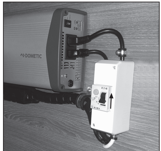
Bij de inverter is een aardlekschakelaar gemonteerd.
