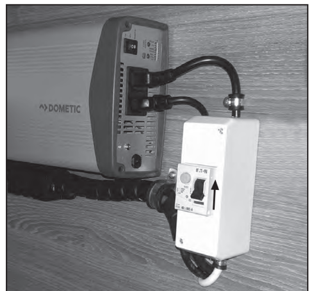
Bij de inverter is een aardlekschakelaar gemonteerd.
