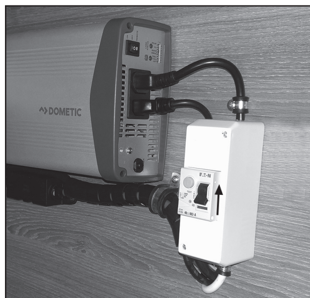
Invertteriin on asennettu vikavirtakatkaisin.
