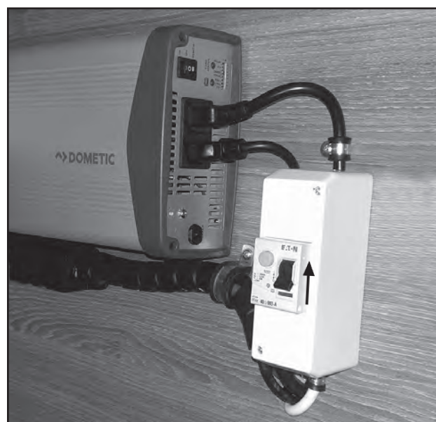
Inverteriin on asennettu vikavirtakatkaisin.
