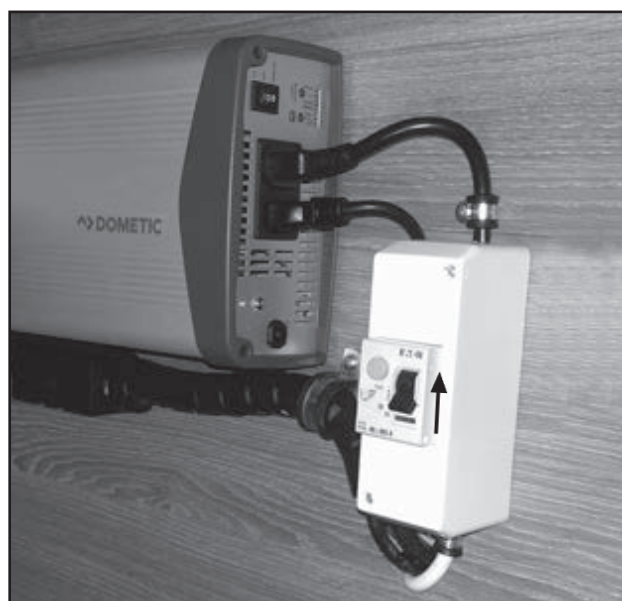
Invertteriin on asennettu vikavirtakatkaisin.
