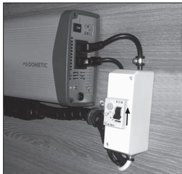
Ein Erdschluss-Schalter ist am Spannungswandler montiert.
