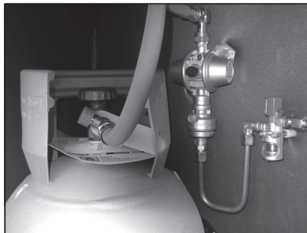
Gassflasken i gasskassen.
