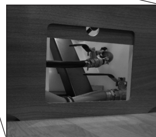
Ventiler for ferskvannstanken: overflyllingsbeskyttelse 45 liter henholdsvis avtapping ved tømning av ferskvannstanken.
