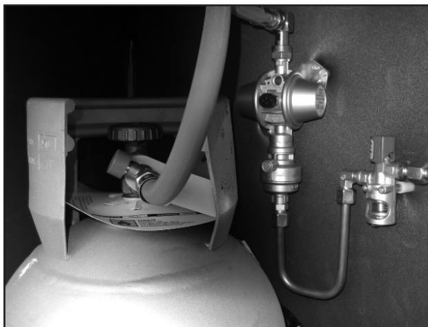
Gassflasken i gasskassen.
