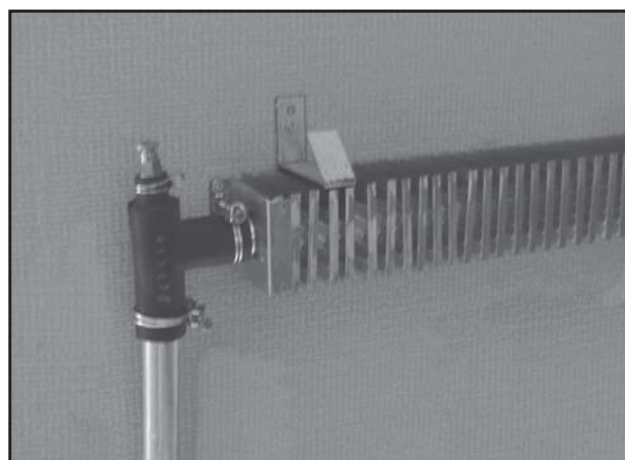
Lämpöpatteri ja letkuliitos ilmausruuveineen.
