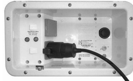
Außenseite des Schaltkastens
