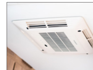
Airconditioning woongedeelte (niet in combinatie met zonnepaneel)
