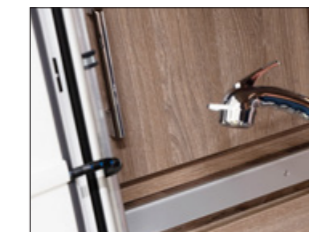
Douche aansluiting buiten
