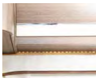
Lysrampe overskap foran
