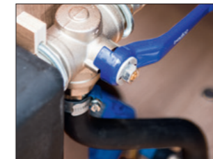
Direkteavløp; forbi kobling gråvannstank
