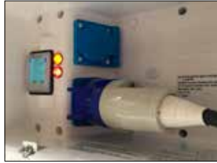
Kilowattmeter in elektriciteits kast
