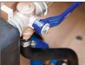
Viemäri; harmaavesisäiliön ohikytkeä
