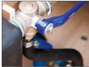
Viemäri; harmaa-vesisäiliön ohikytöntä
