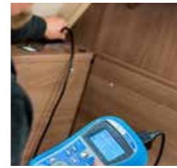
Elektrische Anlage. Die elektrische Anlage und andere wichtige Funktionen werden kontrolliert, bevor die Wohnwagen und Wohnmobile die Fabrik verlassen.
