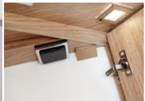
Badrumsskåpet är utrustat med 230V-uttag.
