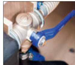
Direkteavløp; forbikobling gråvannstank
