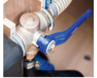
Viemäri; harmaavesisäiliön ohikytentä
