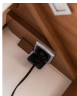
230V uttak i baderomsskap
