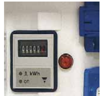
Strømmåler Fastmontert i elboksen. Belysning (X0255) i elboksen.
