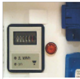
Elmåler Fast monteret i elboksen.
