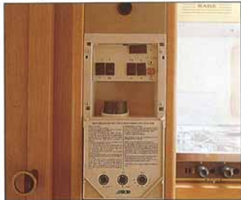
Centralvärmepannan har en lätt åtkomlig kontrollpanel i bekväm arbetshöjd. (R, S, Å)
