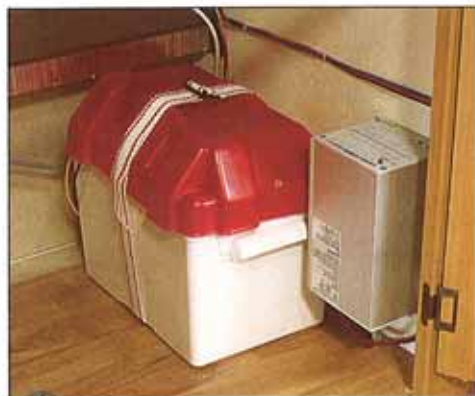
Elcentralen med den effektiva LEAB-laddaren är en tillgång sommar som vinter. (R, Å)
