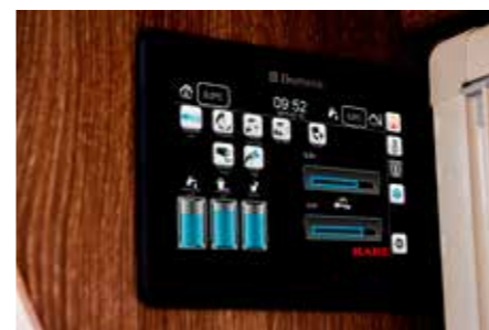
Ajankohtaiset tiedot tuore- ja harmaaveden tasoista ja akkujännitteestä esitetään havainnollisella tavalla.
