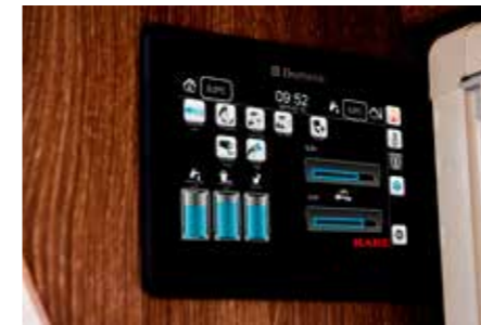
Aktuelle Statusinformationen zu den Füllständen des Frisch- und Grauwassertanks sowie die Batteriespannungen werden übersichtlich präsentiert.
