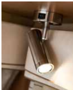
Ny lampe under overskap
