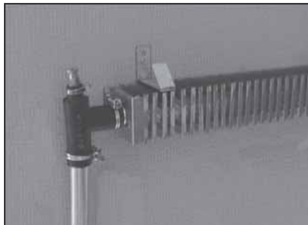
Lämpöpatteri ja letkuliitos ilmausruuveineen.
