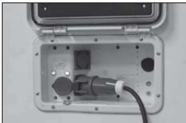
Sähköpatruunalla tapahtuva lämmitys on mahdollinen auton ollessa kytkettynä 230V-verkkoon.
