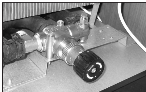
AGS II Pro -lattialämmityksen tunnistaa shunttiventtiilistä, joka on sijoitettu lähelle lämmitintä.
