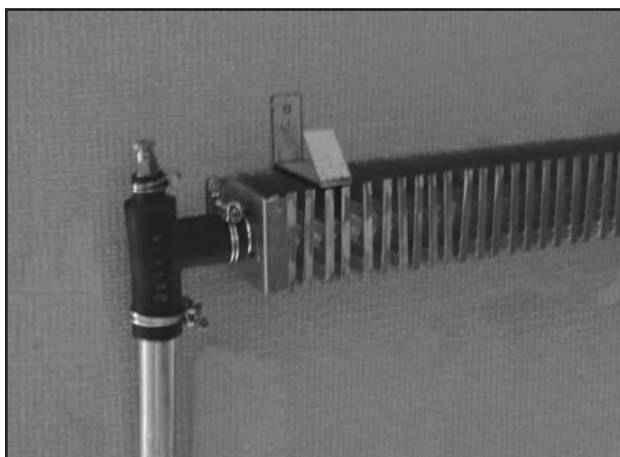
Konvektor och slanganslutning med luftningsnippel.
