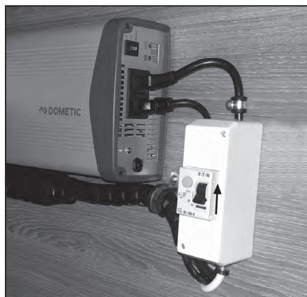
Inverteriin on asennettu vikavirtakatkaisin.
