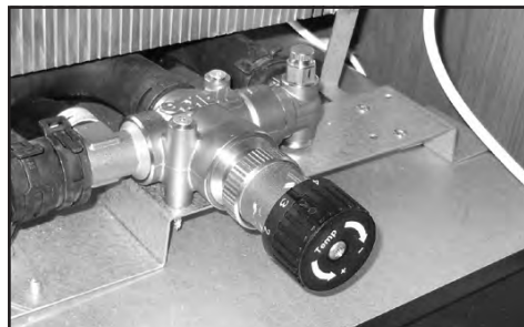
Man kann AGS II Pro am Shuntventil am Heizkessel erkennen.
