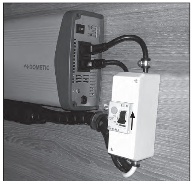
Ein Erdschluss-Schalter ist am Spannungswandler montiert.
